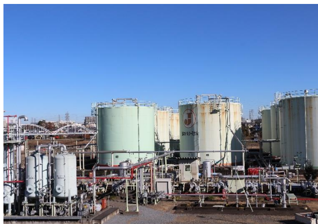
日本オイルターミナルの屋外タンク貯蔵所と製造所
