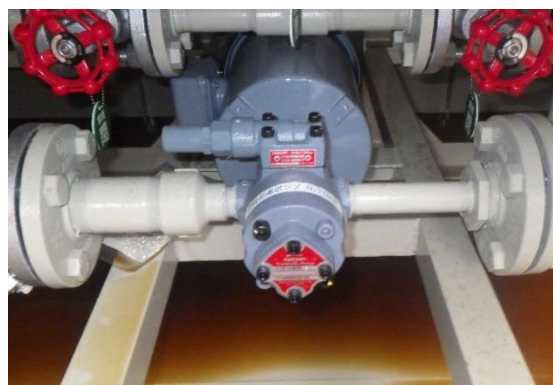
返油ポンプの状況
