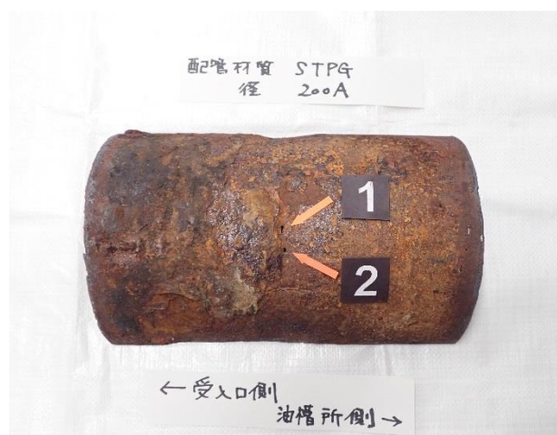
旧受入口ピットと接する部分に生じた埋設配管のピンホールの状況
