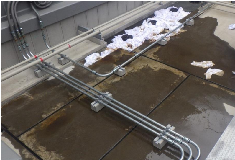
屋上への重油の流出状況
