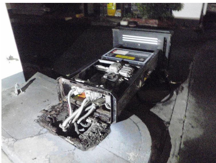
転倒した固定給油設備
