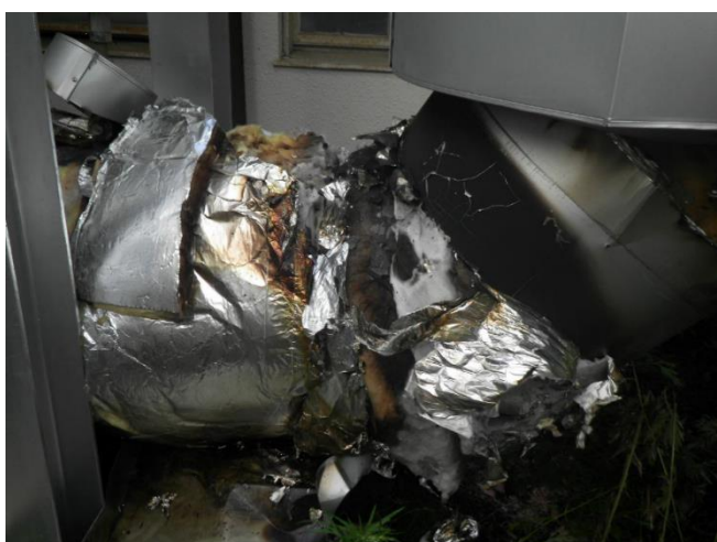
焼損した保温材
