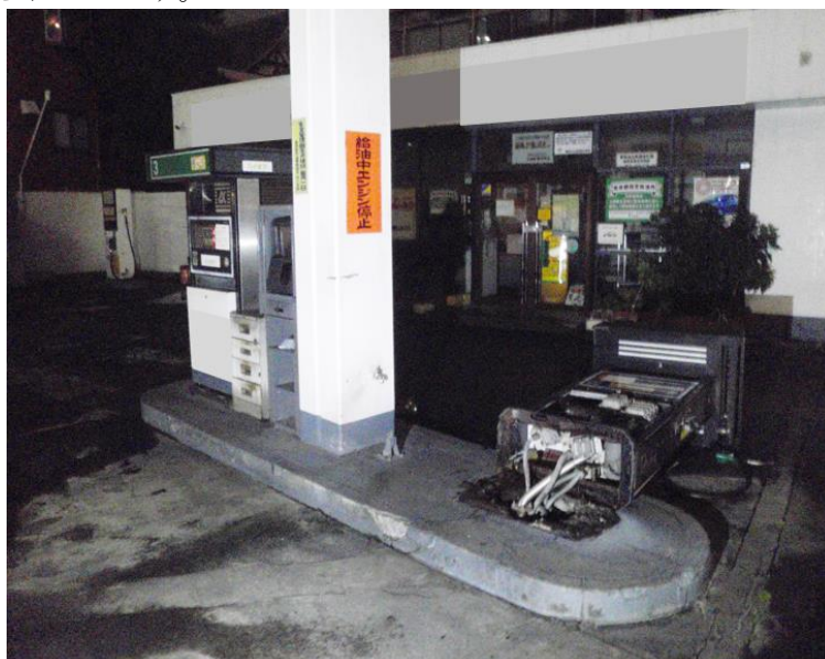
台風通過後の給油取扱所の様子
