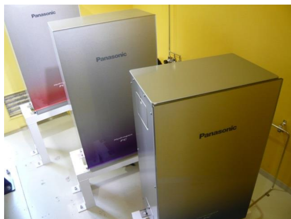
図 3.1.2-6 山梨県米倉山太陽光発電所の 700W 純水素燃料電池 (3 台)
