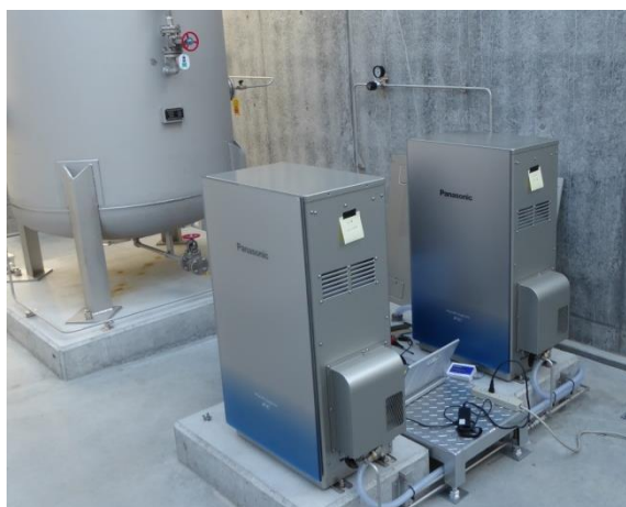
図 3.1.2-7 水素ステーション静岡の 700W 純水素燃料電池 (2 台)
