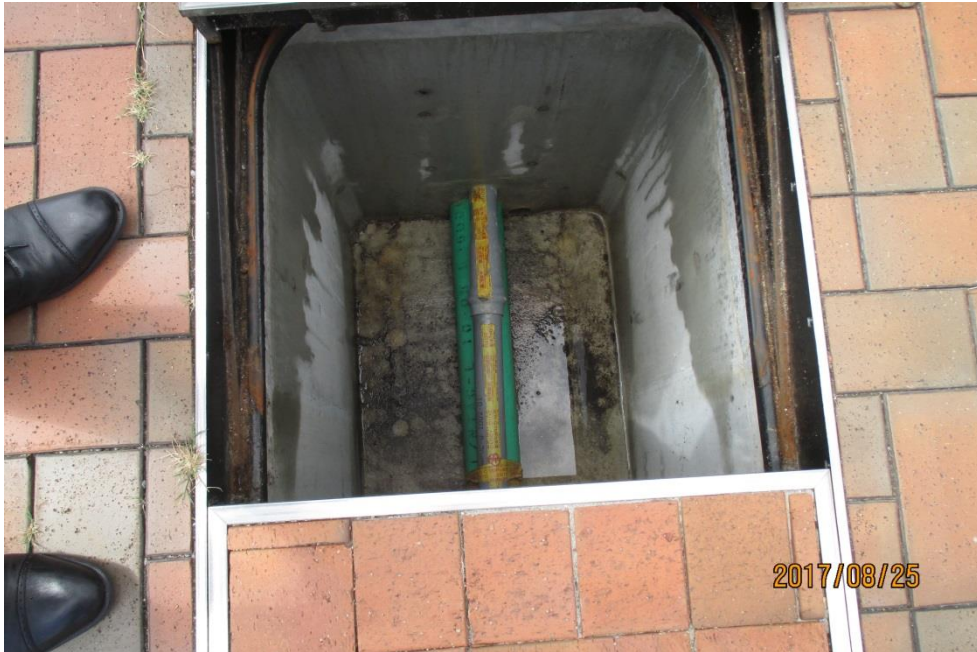
図 2.2.2.3-6 水素配管埋設状態 (見学用開口部にて)
