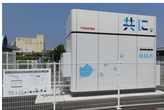
図 3.1.2-5 山口県周南市で稼働中の 100kW 純水素燃料電池
